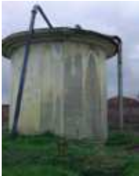
Tangki air PDAM Tirtauli yang dibangun Belanda di Timbang Galung tahun 1918, masih berfungsi sesuai dengan bentuk aslinya (foto/jalatua)
