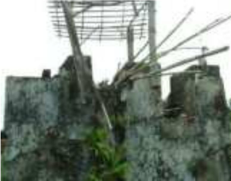
Salah satu sisi puing-puing bangunan eks Pabrik Teh kebun Martoba (foto/dok/jal)
