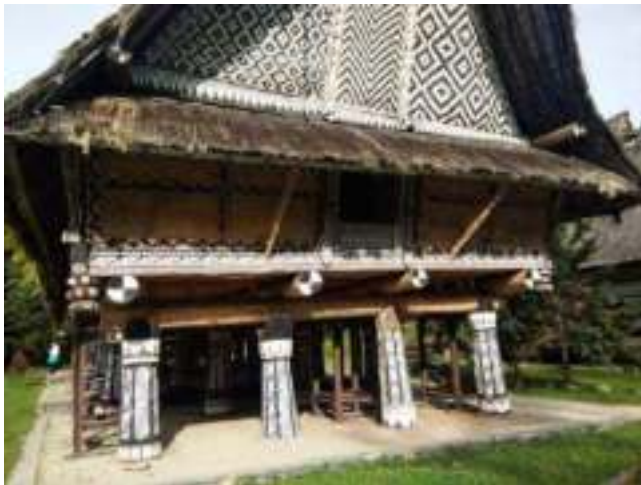
Gambar 5. 41 : Kondisi Rumah Bolon Purba (Tampak Belakang) di Pematang Purba Kabupaten Simalungun. Sudah dalam kondisi rusak. Terlihat tiang besi menopang lantai yang nyaris rubuh (Sumber: dok. TACB Kab. Simalungun).
